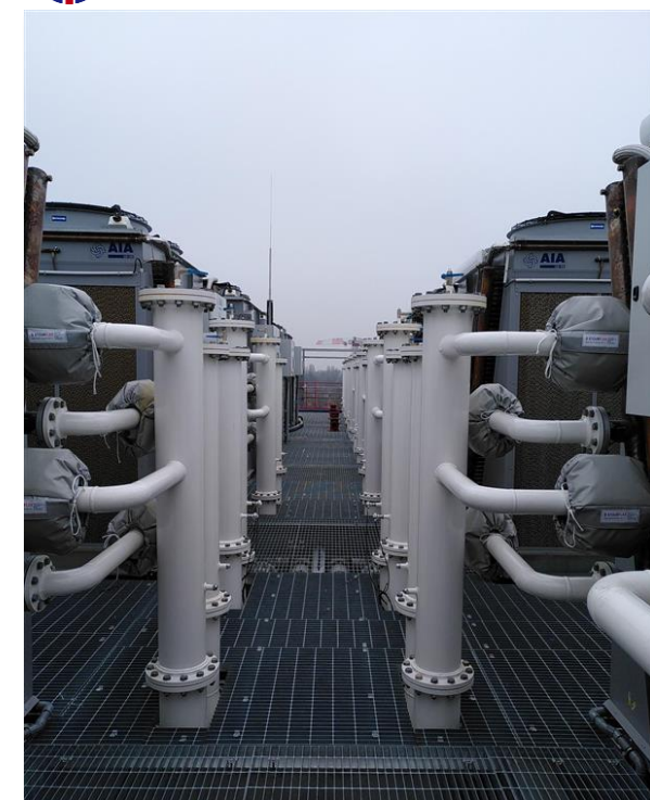
Principaux procédés consommateurs d'eau du site (dry-coolers)
